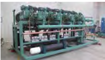
Schraubenverbundanlage TPN – OSK 8571-K mit vier offenen Schraubenverdichtern und einem Frequenzumrichter.
