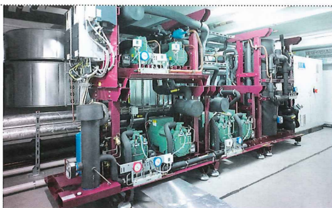
Transkritische CO 2 -Zentralkälteanlage „Roxsta“ von Teko
